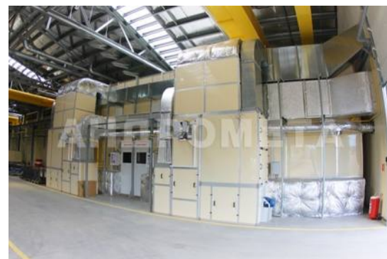
Окрасочно-сушильная камера с контролем температуры.
