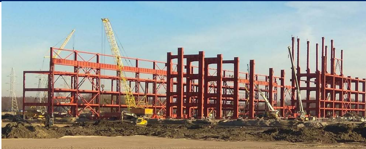
Объект: Приморская ТЭС, г. Калининград, 2019 г.
