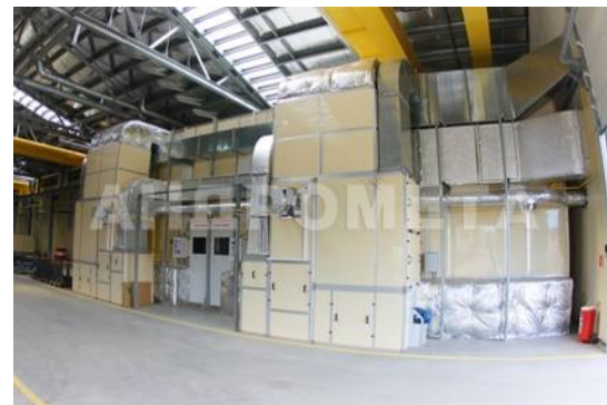
Окрасочно-сушильная камера с контролем температуры.
