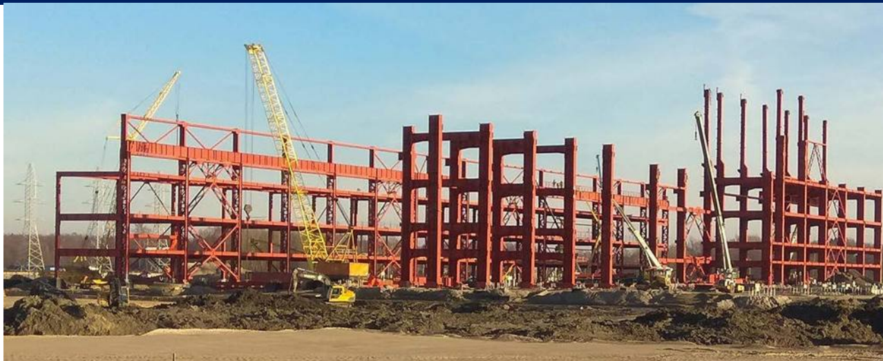
Объект: Приморская ТЭС, г. Калининград, 2019 г.
